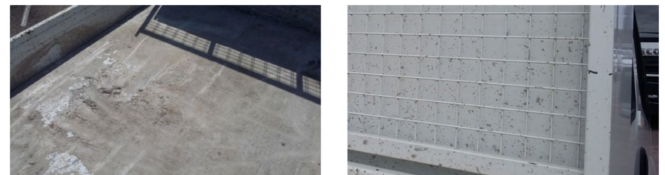
Spuren von Beton oder chemischen Produkten, die \geq \frac{1}{4} der Oberfläche des Trichters bedecken
