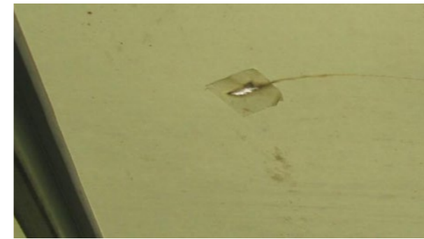
🔧 Dachfläche: Durchstoßen oder gerissen, kann auf wirtschaftliche Weise repariert werden
