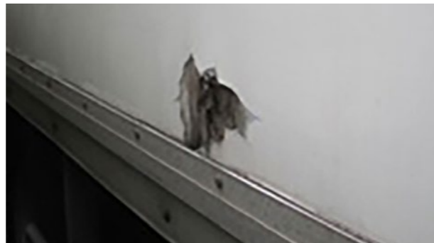
Holzseitenverkleidungen: Beschädigte Holzstütze \geq 20\text{ cm}
