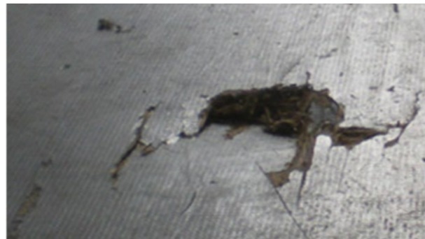
🔧 Bodenbelag: Verformungen oder Durchstoßungen, die auf wirtschaftliche Weise repariert werden können
